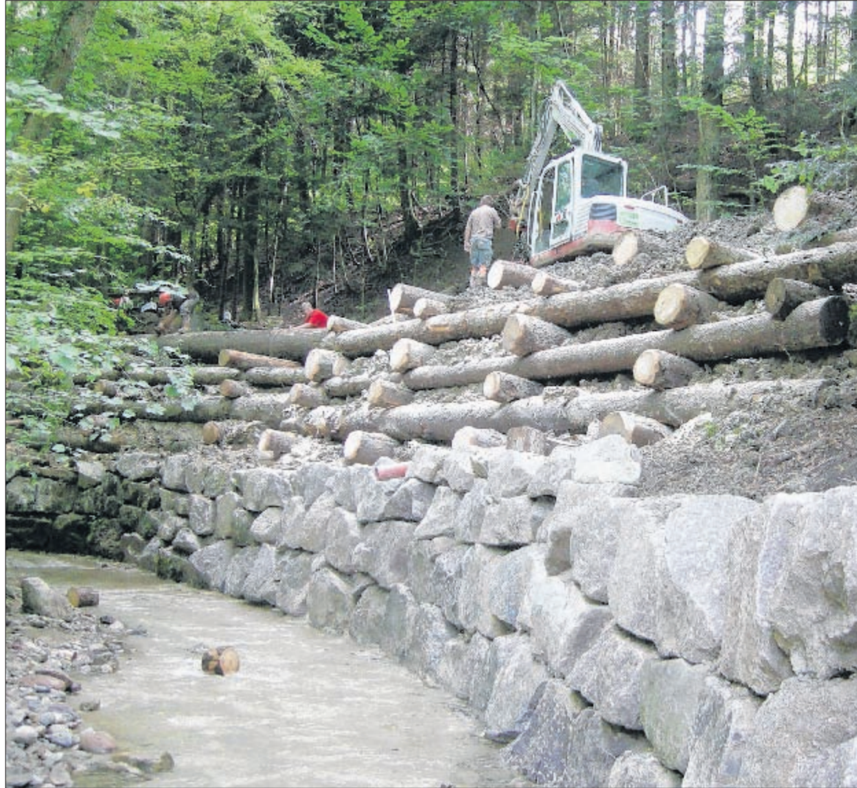
Sanierungsarbeiten am Ufer des Tüftelbaches in Egg, das infolge von Erosion eingebrochen ist. (ü)
